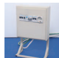
Cuadro eléctrico con enchufe
