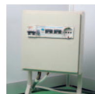
Cuadro eléctrico con enchufe
