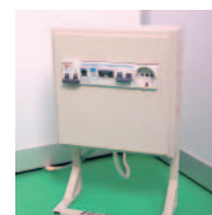
Cuadro eléctrico con enchufe
