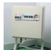
Cuadro eléctrico con enchufe
