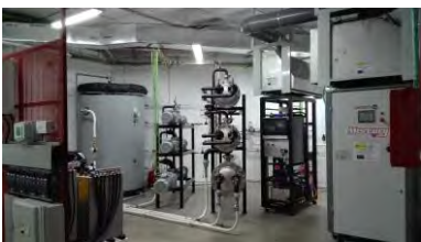
Micro red con sistema de almacenamiento híbrido (baterías de gel e hidrógeno). CENTRO NACIONAL DEL HIDRÓGENO.
